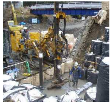
削孔は、ロータリーバーカッション方式による泥水削孔が標準。 水槽→鋼管内→鋼管と外周地盤の隙間→水槽の流れで泥水を循環。
