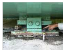
支承と沓座の劣化
