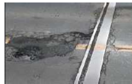
損傷状況(上面側)
