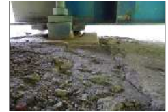
橋脚天端面の劣化損傷
