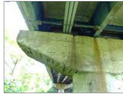
被りコンクリートの剥落
